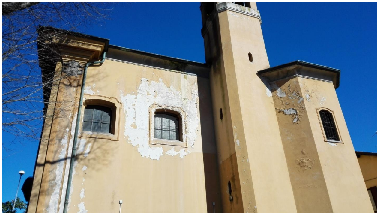
foto n. 7 : vista esterna (efflorescenze su murature)
